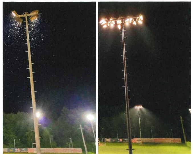
Abb. 5: Flutlichtanlage in Zirl (Tirol) links vor, rechts nach der Umrüstung. Durch die neue zielgerichtete LED-Beleuchtung wurde die Lichtimmission am Auwald-Rand auf ein Zehntel reduziert. (Fotos: Stefanie Suchy)
